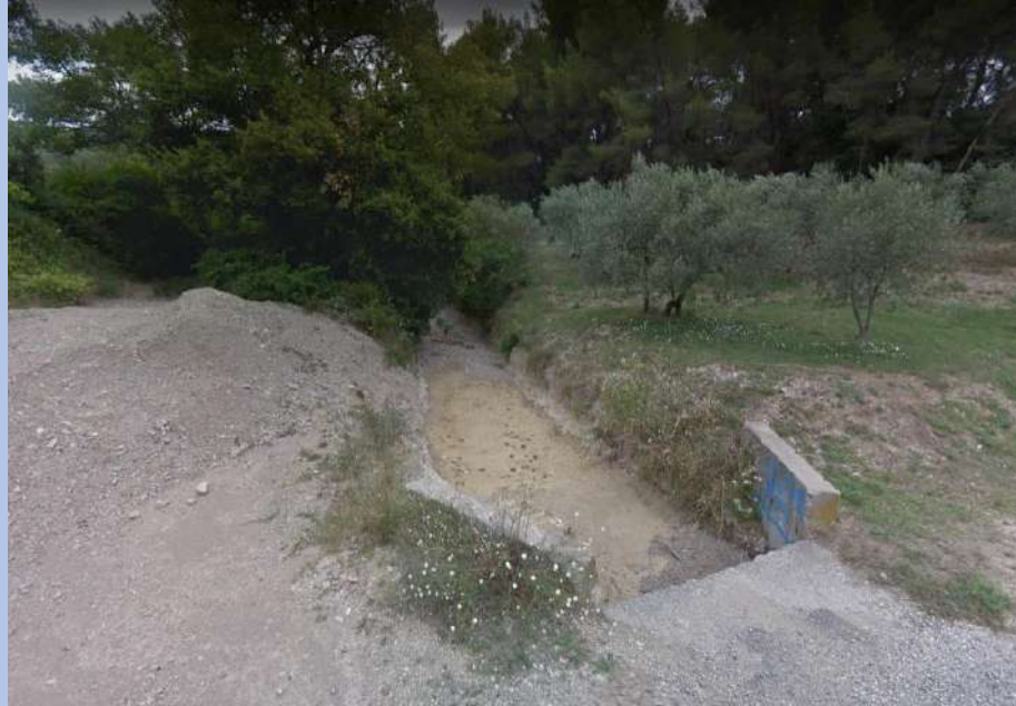
Figure 10 : ouvrage de franchissement vue du chemin de Piétramal vue vers l'amont (Printemps 2022)
